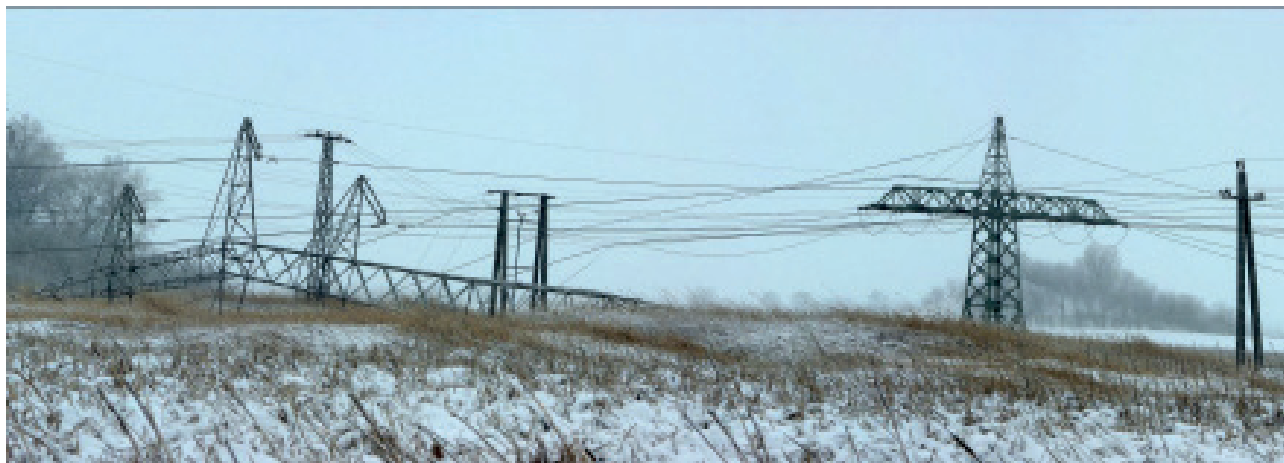
18. ábra: Kidőlt 220 kV-os távvezeték 120 és 20 kV-os távvezetékekre szakad sodronyai (2013. március 15.)
