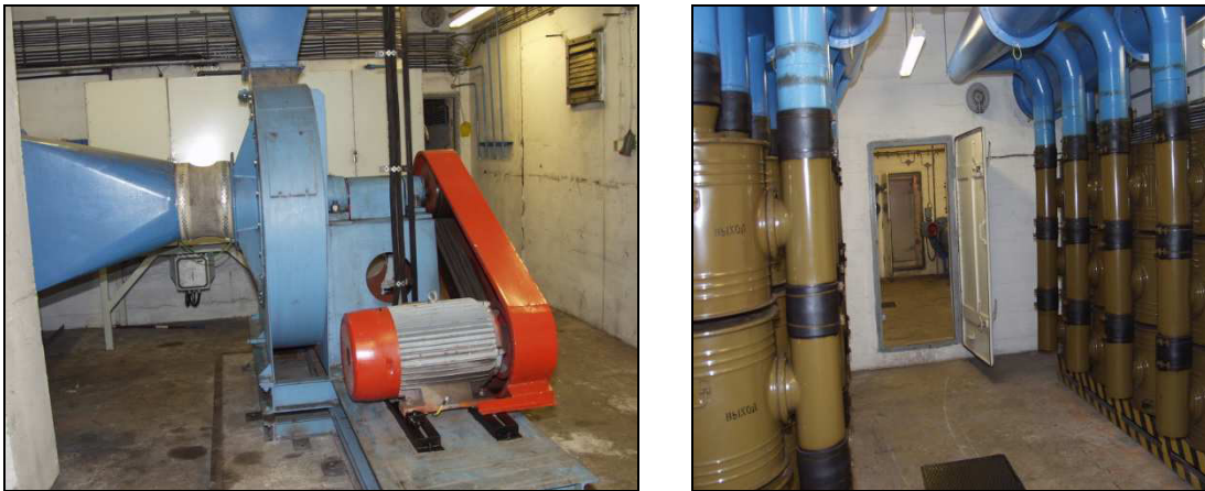
29. számú ábra: A főszellőző ventilátor és a harcgáz szűrők telepítése, beépítése [44]
